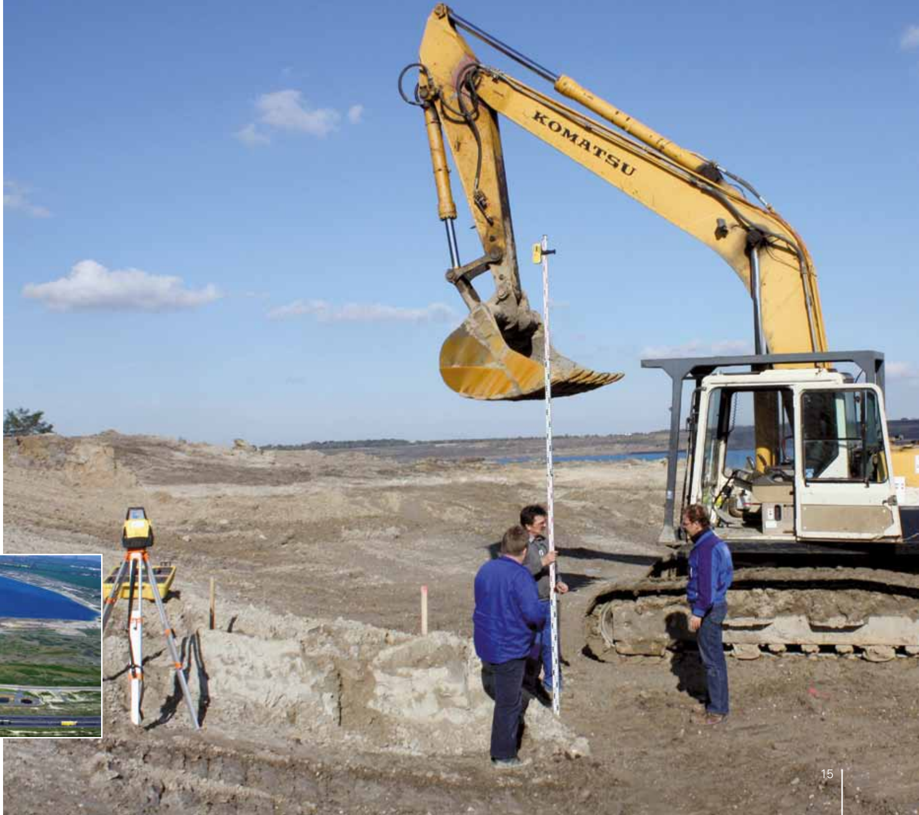
Bauvorbereitung im Bereich des künftigen Hafenbeckens an der Magdeborner Halbinsel am Störnthaler See, 2009
