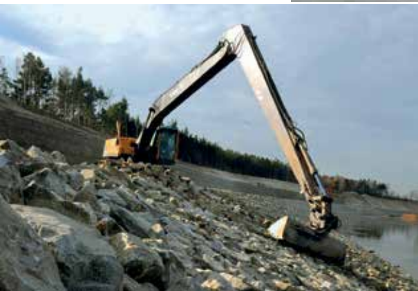
Ufersicherung mit Gabionen am Partwitzer See, 2012 Sprengverdichtung im Bereich der Restlochreihe, 2007 Befestigung von Uferböschungen am Partwitzer See, 2011
